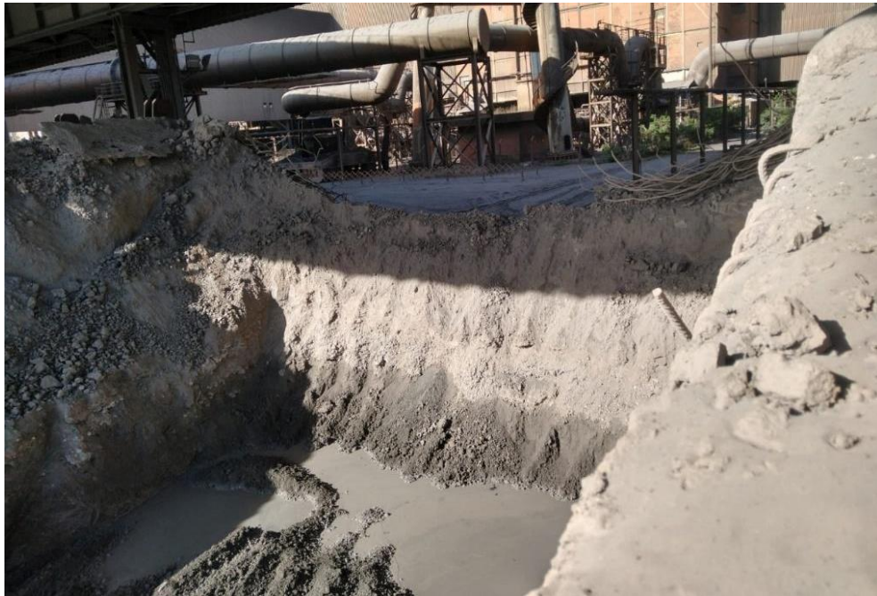
Figura 17 - Baia de escória avariada em manutenção
